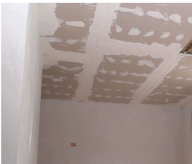
Fissaggio lastra di rivestimento in cartongesso standard ancorata alla struttura metallica e stuccatura
