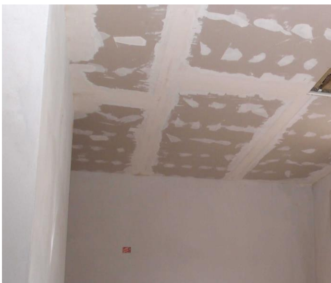
Fissaggio lastra di rivestimento in cartongesso standard ancorata alla struttura metallica e stuccatura con UNIVERSAL GIPS
